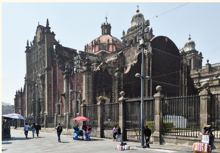
A katedrálishoz hozzáépült Sagrario templom az aztékok által is kedvelt, vöröses színű tezontle nevű vulkánikus kőzetből épült. Sajnos ennek keleti homlokzata is erősen dől kifelé az agyagos, gyenge teherbírású általaj mozgása miatt.
